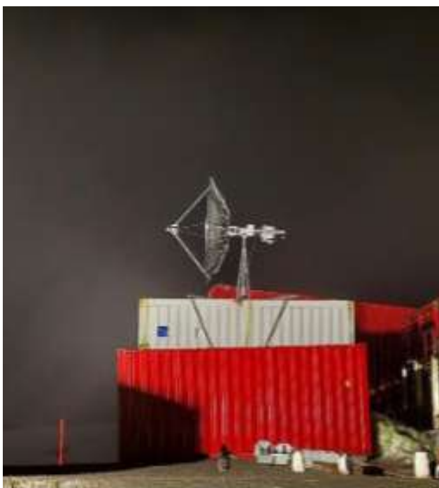
Imagen 5. Instalación en sitio de la Estación de Control FACSAT-2 en la Base Chilena O'Higgins.
